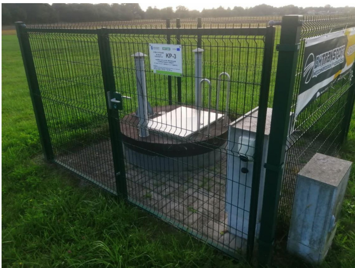
Ryc. 7 Przepompownia ścieków sanitarnych KP-3 w sąsiedztwie terenu wskazanego na załączniku nr 1 do projektu planu
